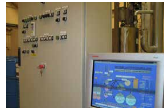
Styrings og overvåkningssystem gjør håndtering av kjemikalier sikrere.
