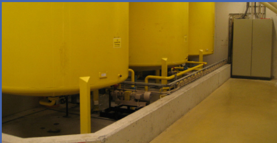
Lagertanker for kjemikalier er sikret mot utslipp.
